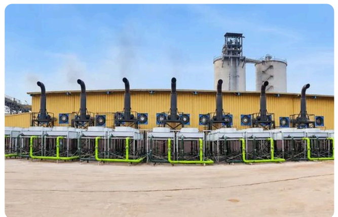
Central eléctrica industrial
