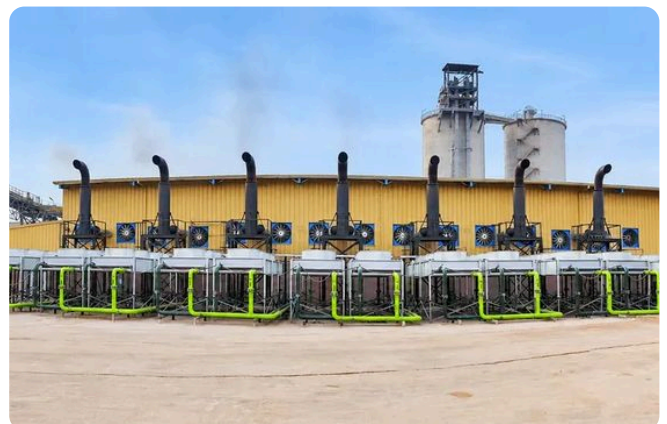
Centrale électrique industrielle
