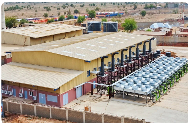
Solução de arrefecimento com fabricantes de motores renomados
