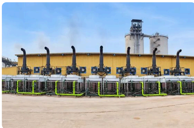
Usina de energia industrial
