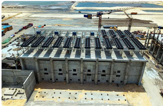
Usina a HFO com radiadores TECS
